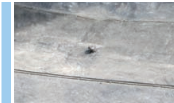
Рис. 3.5.10 Повреждение мембраны шляпкой самореза при применении тарельчатого металлического держателя по минераловатному утеплителю
