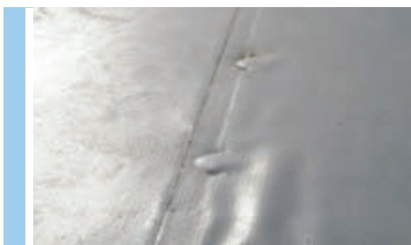
Рис. 3.5.7 Дефект сварного шва
