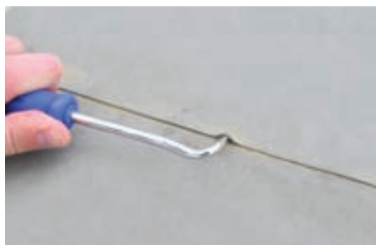
Рис. 5.2.9 Контроль при помощи специальной чертилки
