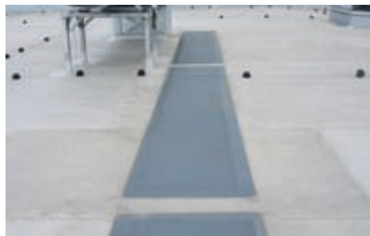
Рис. 4.2.5 Пешеходная дорожка ТехноНИКОЛЬ на кровле
