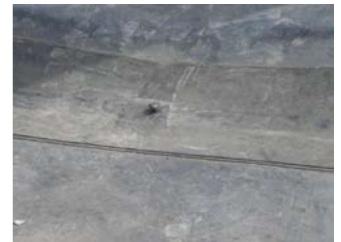
Рисунок 2.5.8 Повреждение мембраны шляпкой самореза при применении тарельчатого металлического держателя по минераловатному утеплителю.
